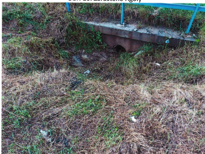
Obr. 11. Priepust s nedostatočným priemerom
