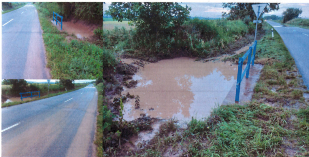
Obr. 6. Zapchatý priepust pod cestou
