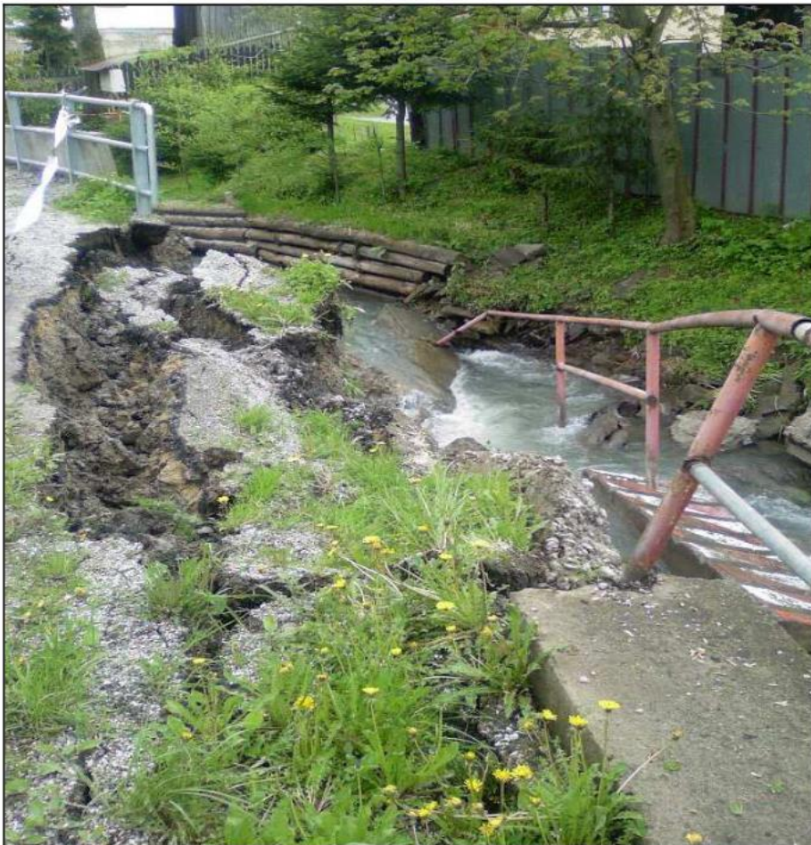
Obr. 8 Poškodený úsek cesty III/5423 v Malej Frankovej po povodni v máji 2010
